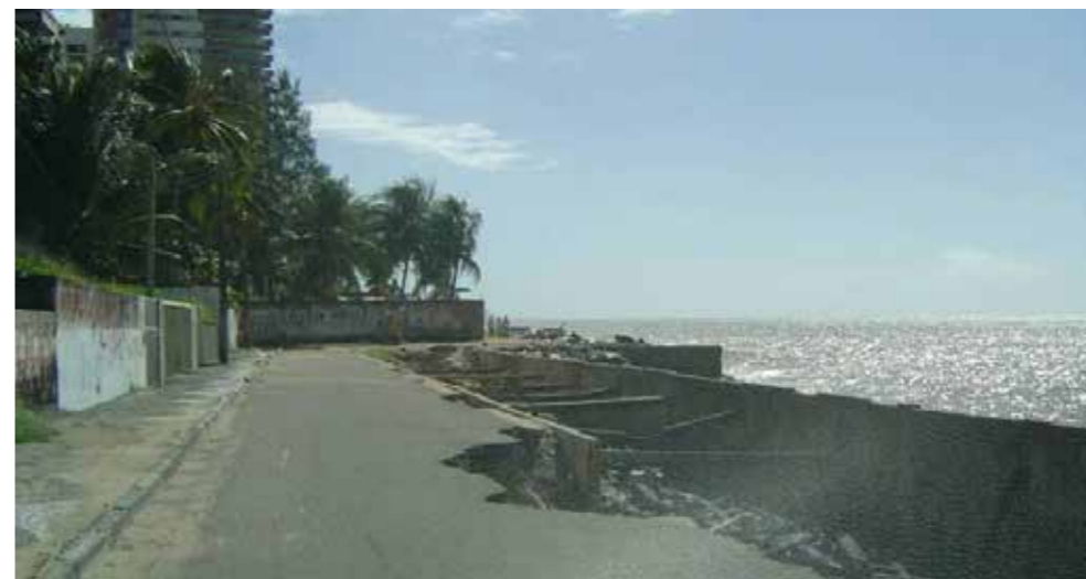
Figura 32 – Erosão em Jaboatão dos Guararapes - PE.
