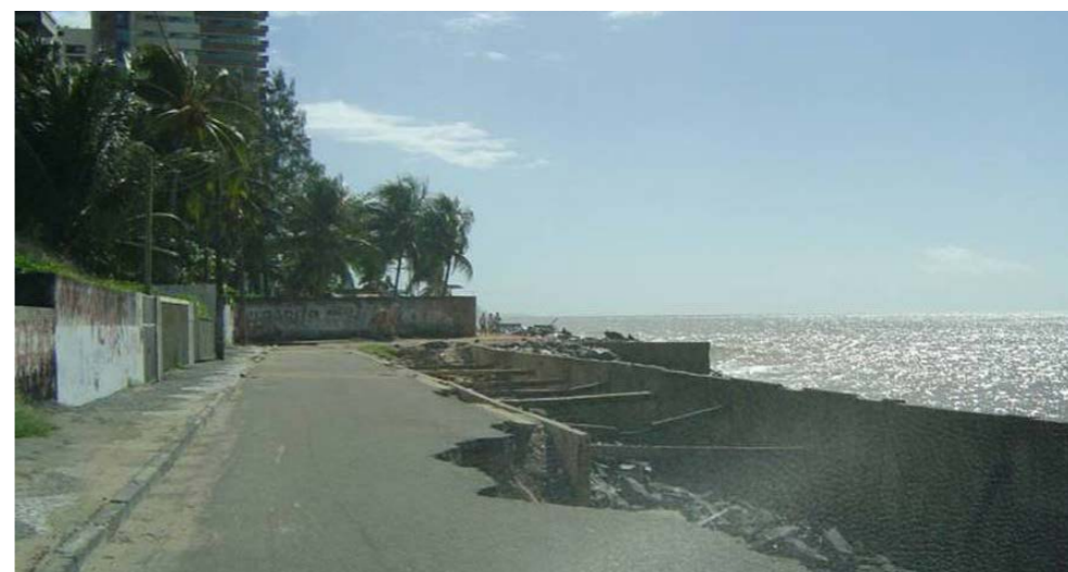
Figura 32 – Erosão em Jaboatão dos Guararapes - PE.
