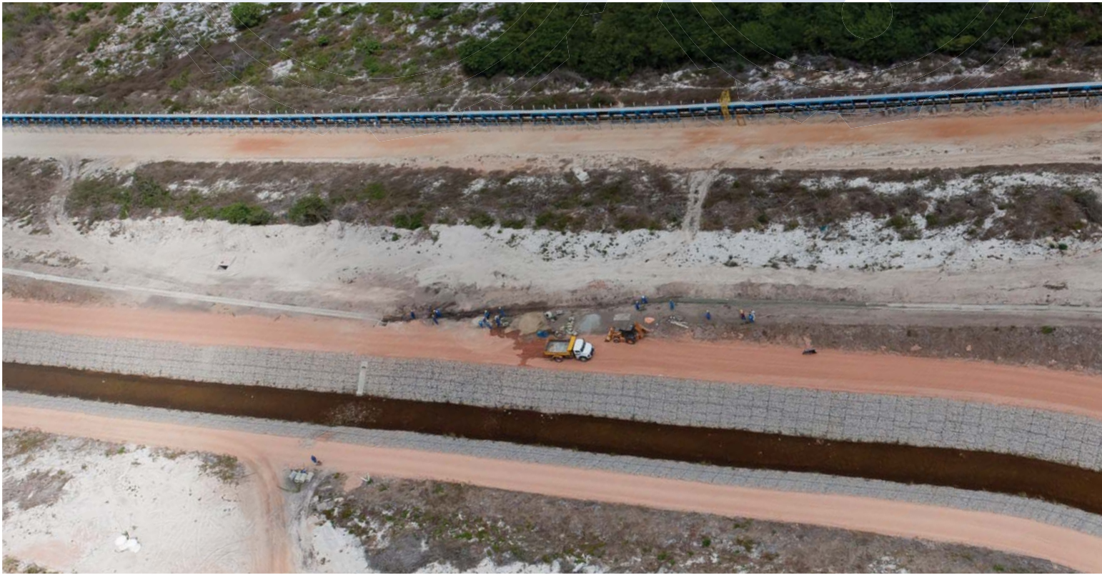
Correia Transportadora e Canal
