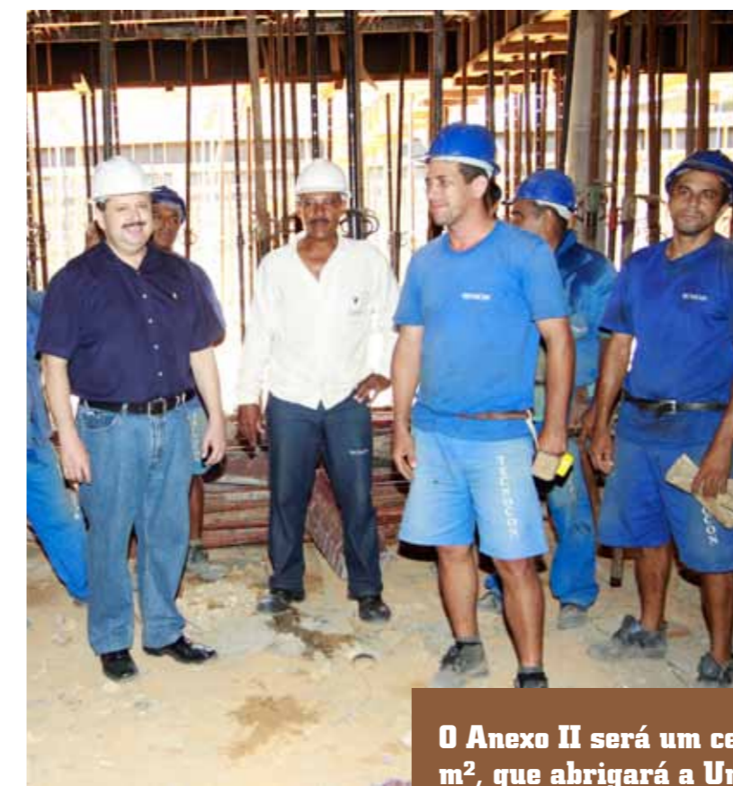
&gt;&gt; Deputado Domingos Filho visita as obras do novo estacionamento no subsolo do prédio da AL.
